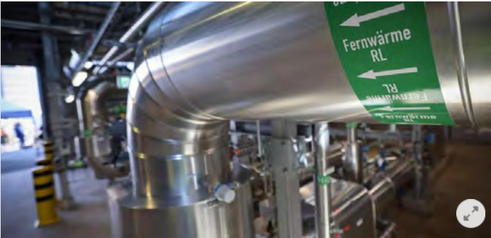
Fernwärmeröhre in einer Wind-zu-Wärme-Anlage (Power-to-Heat-Anlage) auf dem Gelände des Heizkraftwerks Wedel.
